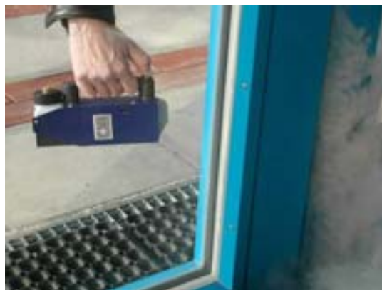
Sprawdzanie szczelności – ucieczka powietrza przez nieszczelną ramę okienną widoczna dzięki użyciu dymu
