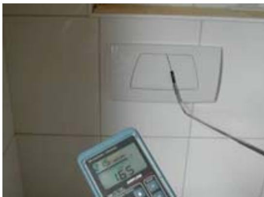
Sprawdzanie szczelności – ucieczka powietrza przez oprawy i armaturę, pomiar wykonany anemometrem
