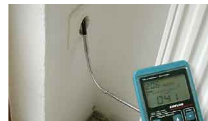
Luft einströmung durch eine Steckdose
