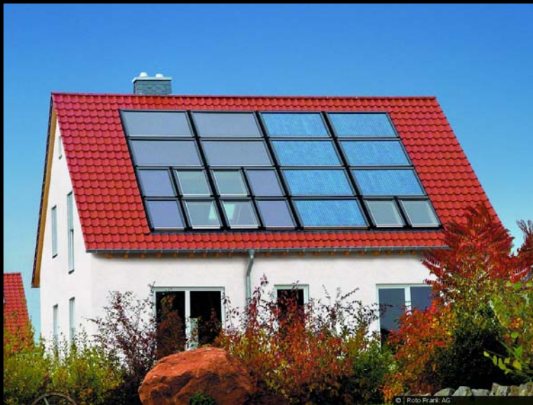
Solarwärmeanlagen zur Trinkwassererwärmung und Heizungsunterstützung (links), kombiniert mit PV-Anlage und Dachfenstern
