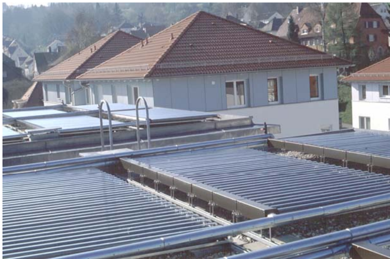
Bild 7: Kollektorfeld in Schwäbisch-Gmünd
