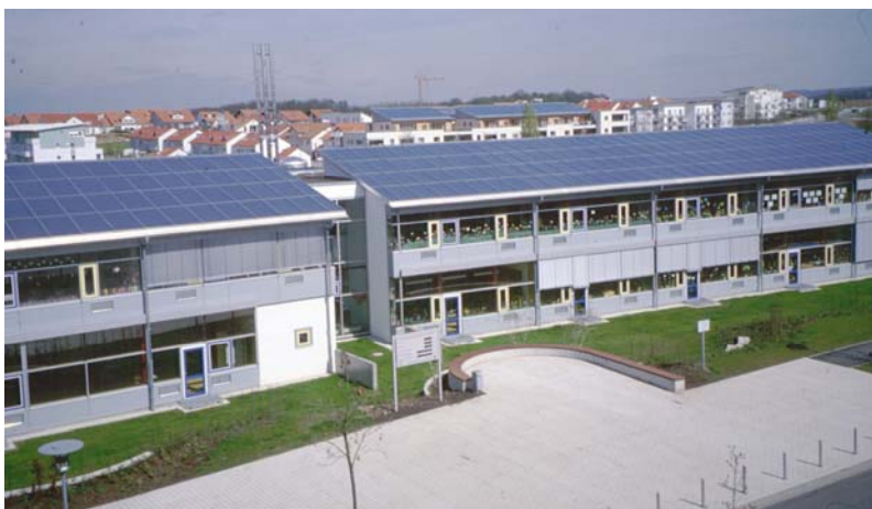
Bild 3: Solardach auf der Grundschule in Neckarsulm
