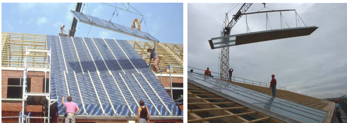
Bild 2: Montage von großen Kollektorflächen in Hamburg-Bramfeld 1996 (links) und eines Solardachs in Friedrichshafen 2004 (rechts)
