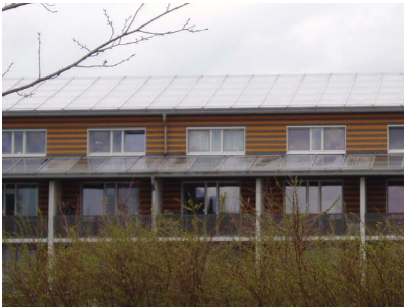
Bild 5: Kollektorfeld in Hannover-Kronsberg 2000
