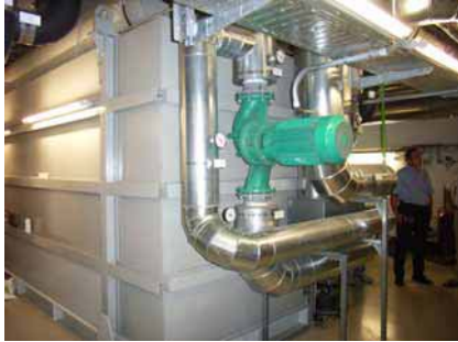
Mayekawa / Mycom ADR 350 kW Nennkälteleistung Installation: FESTO AG & Co, KG
